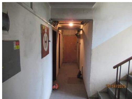
Společné sklepní prostory
