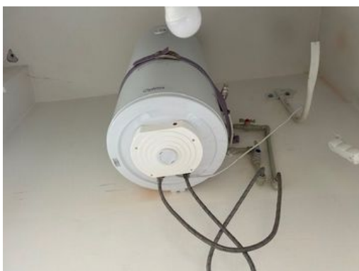
el. boiler v šatně
