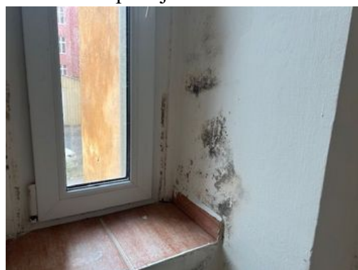
plíseň u okna v šatně
