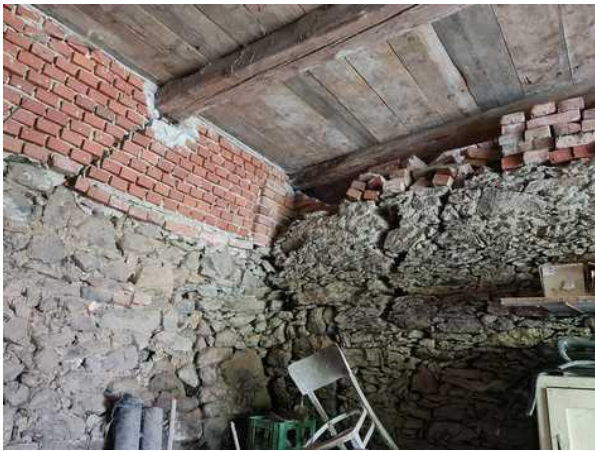
poškozená zeď hospodářské části
