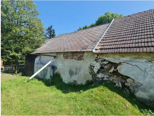
poškozená hospodářská část
