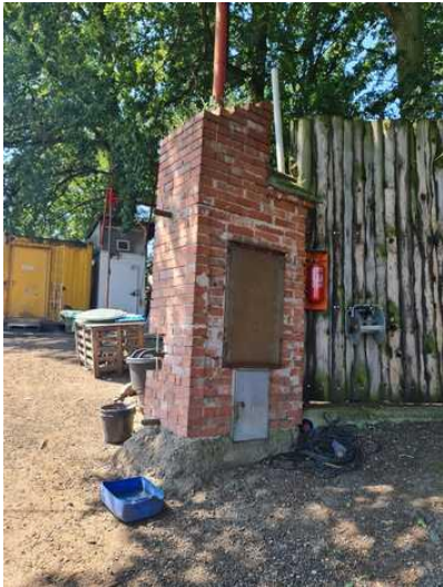
pilíř elektro vlastníka sousedního pozemku
