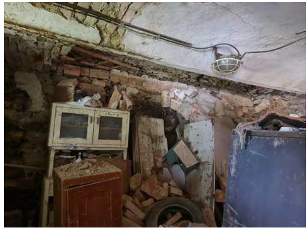
poškozená zeď a strop hospodářské části
